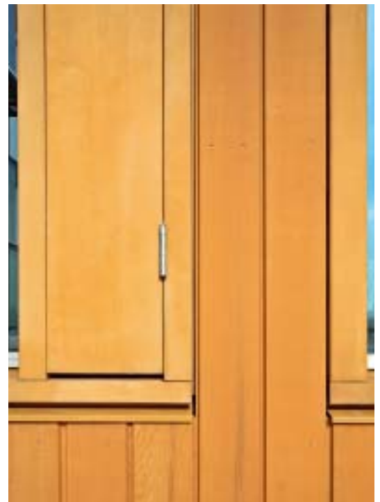
Detail klepraam, dat voor de beluchting zorgt.
